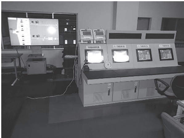
写真 17 改修後のポンプ監視操作設備
