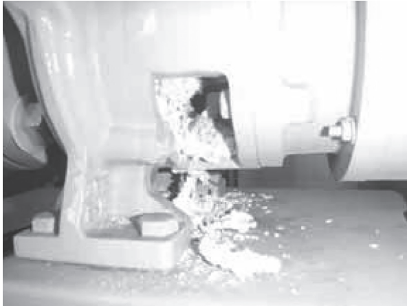
写真9 液体抵抗器循環ポンプ電解液漏れ
