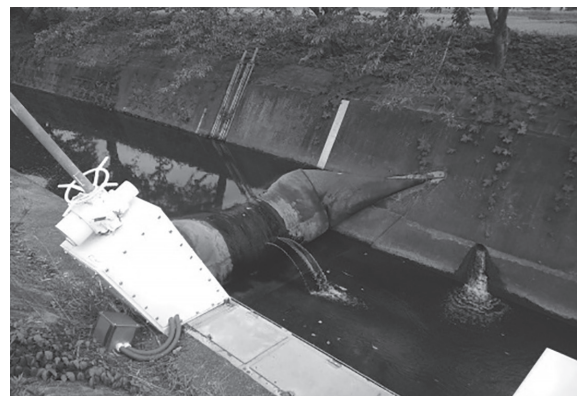
写真4 水空気式ゴム堰袋体の破孔漏水
