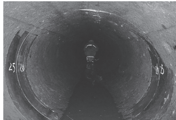
写真2 FRPM 管のたわみ、変形
