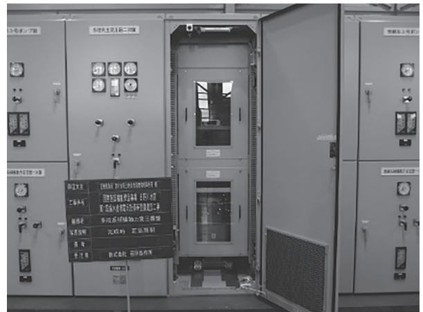
写真 19 トップランナー型変圧器
