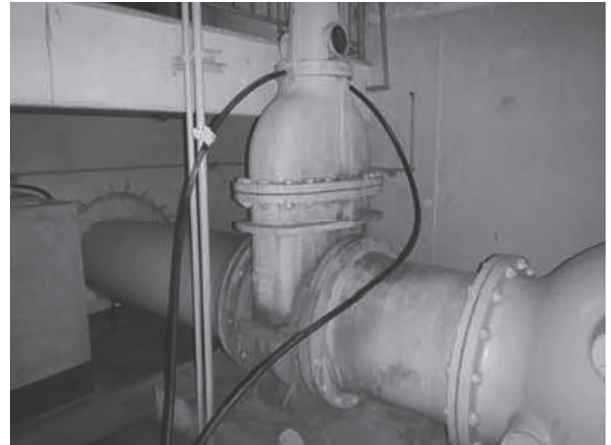
写真11 吐出弁の漏水による錆
