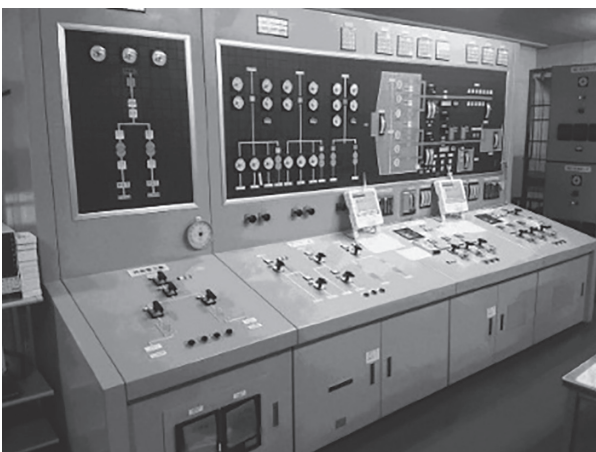
写真7 ポンプ監視操作設備（改修前）
