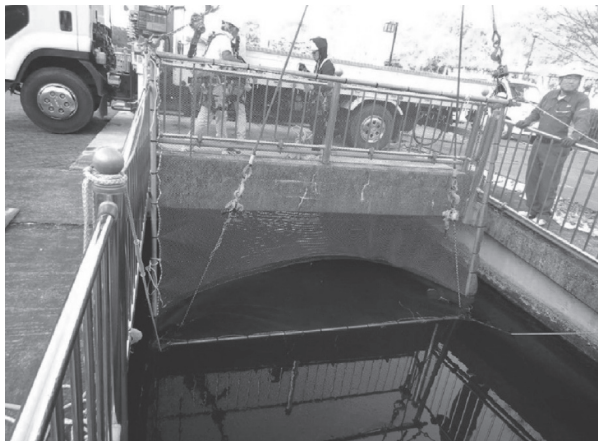
図-8 回収ネット設置状況
