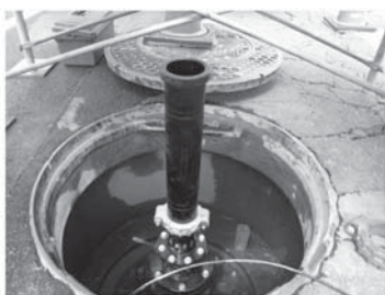
写真-6 SB投入口
