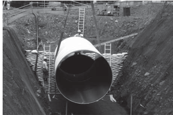
写真-3 幹線・支線パイプライン
